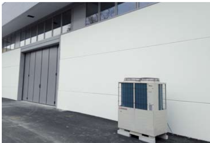
Immagine 1. Posizionamento dell'unità Q-ton all'esterno della fabbrica.
