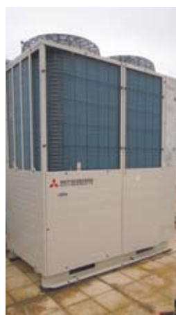
Immagine 2. Particolare dell'installazione di Q-ton con serbatoio, sul tetto dell'hotel.
