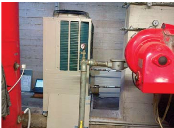
Immagine 2. Installazione della pompa di calore Q-ton nella centrale termica in locale seminterrato.
