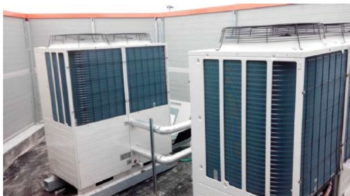
Immagine 2. Posizionamento dei 2 Q-ton sul tetto dello studentato.
