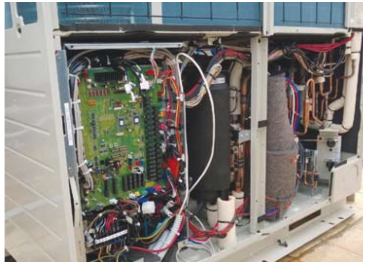
Immagine 2. Dettaglio del Q-ton installato.
