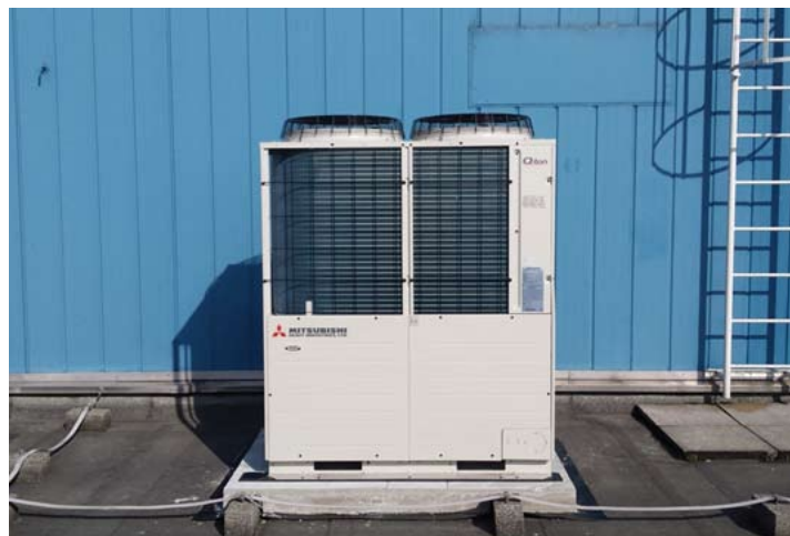
Immagine 2. Posizionamento del Q-ton sul tetto dell'azienda (vista laterale).
