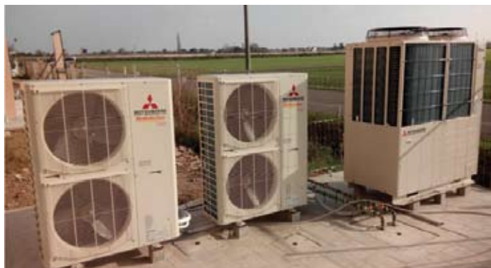
Immagine 2. Posizionamento del Q-ton accanto a 2 unità esterne del sistema Hydrolution.
